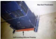
Bild: Stromschiendurchbruch in Betondecke mit 2-stündiger Brandrate. geprüft gemäß ULC-S115 für 120 Minuten Feuerwiderstandsdauer und 30 PSI 2
